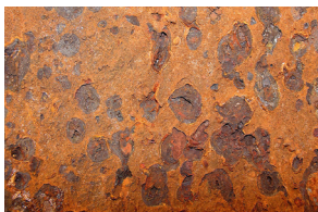
Korrosion eines Heizkessels
